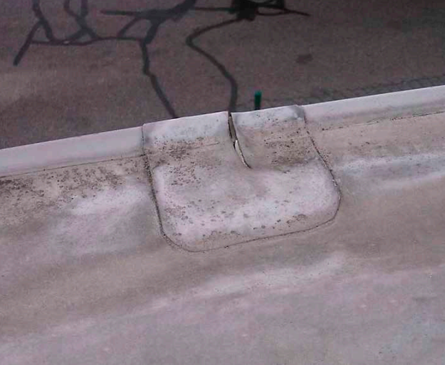
Dachbahn über Verbundblech eingerissen
