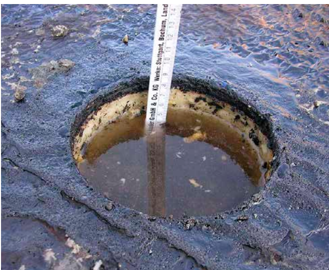
Wärmedämmung extrem durchfeuchtet, Wasser steht auf der Dampfsperre
