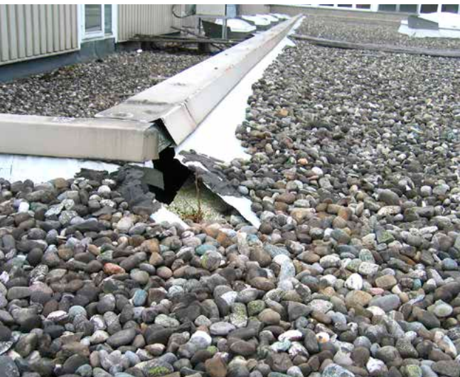
Dachbahn im Anschlussbereich aufgerissen
