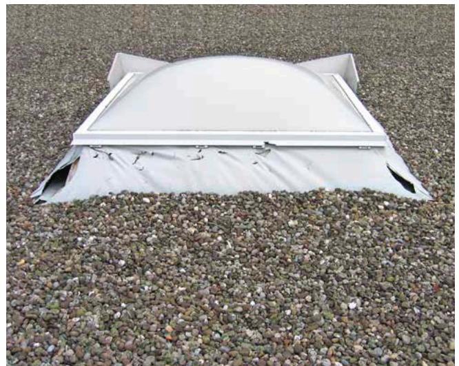
Dachbahn an der Lichtkuppel aufgerissen
