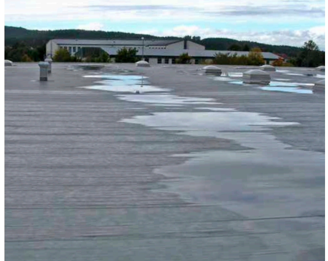
Stehendes Wasser ohne Oberflächenschutz führt zu hohen thermischen Belastungen
