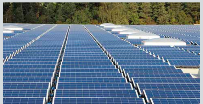
Abb. 5/3: Industrie-Leichtdach mit Photovoltaik-Anlage
