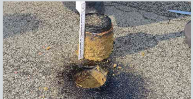
Abb. 17/2: Der Dachaufbau ist bis zur Dampfsperre einsehbar. Die entnommene Wärmedämmung wird geprüft und anschließend die geöffnete Stelle wieder fachgerecht abgedichtet.
